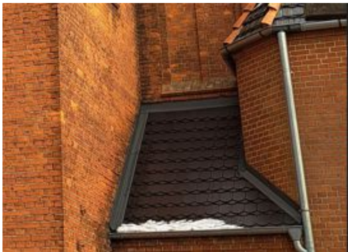
Dach wykonany niezgodnie z wymaganiami konserwatorskimi - opierzenia powinny być oddachówkowe oraz dachówka niezgodna z historycznym wzorem
