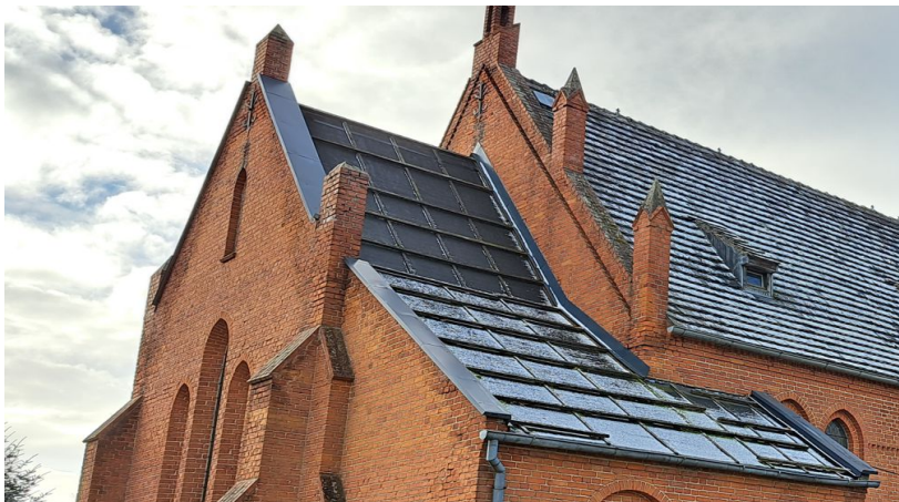
Brak pokrycia dachowego zakrystii oraz prezbiterium - opierzenia nie zgodne z wymaganiami konserwatorskimi
