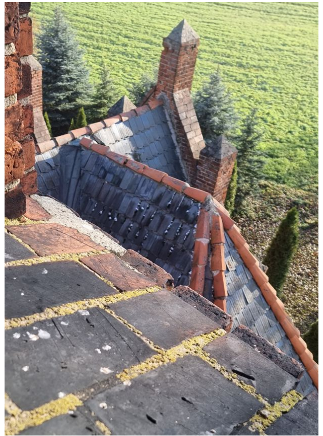
Widok na dach z wieży - widoczny brak opierzeń przytattkowych, zurzyte szlmy cementowe sterczyn oraz wtórne gąsiory dachowe
