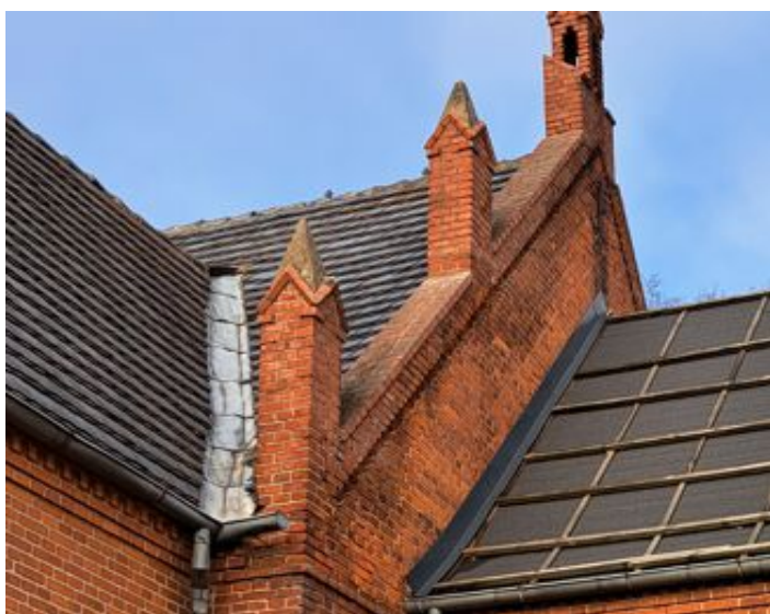
Zniszczone opierzenia koszowe
