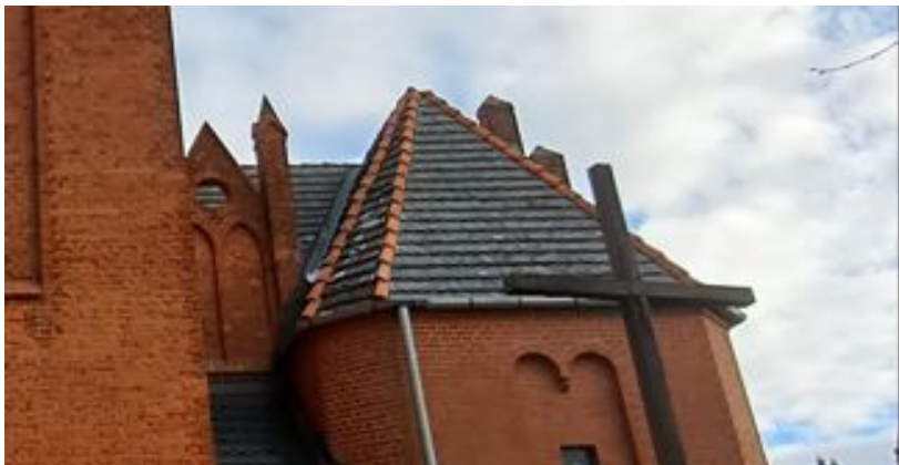
Widok na dach z wieży - widoczny brak opierzeń przytattkowych, zurzyte szlmy cementowe sterczyn oraz wtórne gąsiory dachowe
