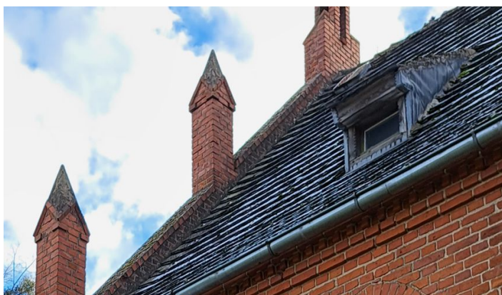
Brak opierzeń krawędziowych attyk na styku z dachówką
