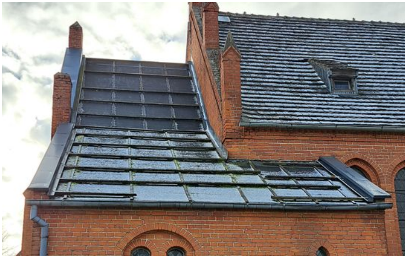
Brak pokrycia dachowego zakrystii oraz prezbiterium
