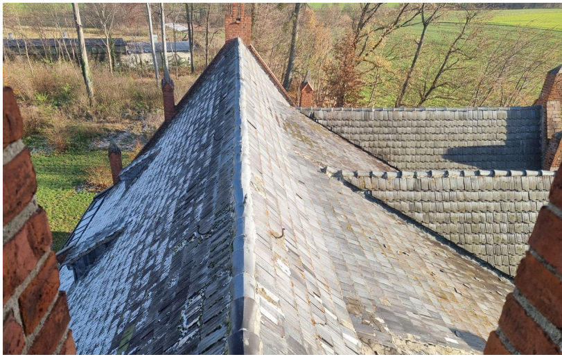
Widok na dach z wieży - widoczny brak opierzeń przytattkowych
