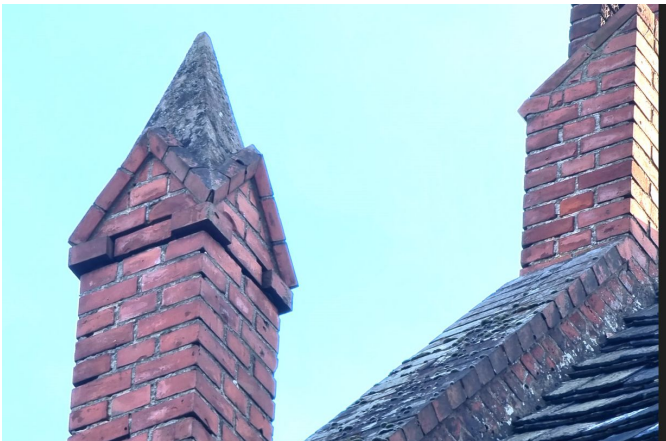
Zniszczone attyki ceglane do naprawy wraz z szlamami sterczyn
