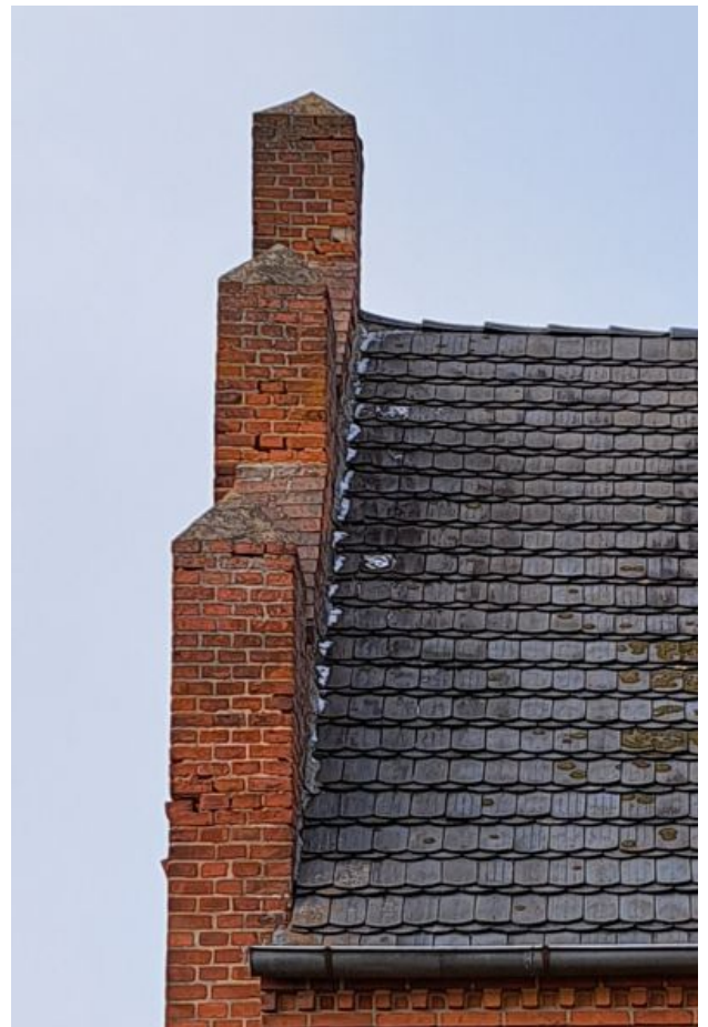
Zurzyte szlmy cementowe sterczyn oraz brak opierzeń styku dachówki i attyki
