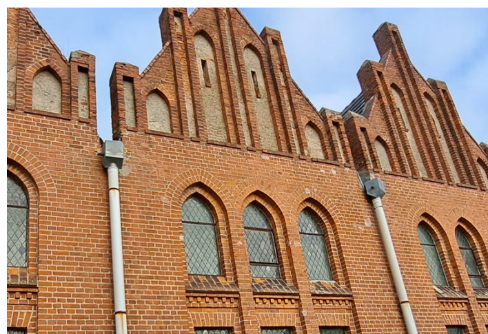
Zniszczone kosze dachowe z rurami spustowymi z rur kanalizacyjnych PCV
