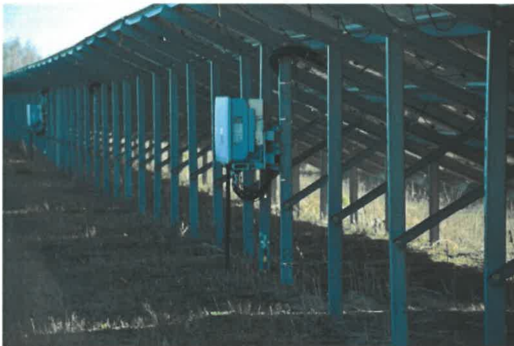
Fotografia 1. Przykładowy inwerter przymocowany do konstrukcji wsporczej.
